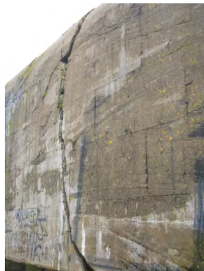
Fracture avec rejet horizontal pluricentimétriques en haut de mur M4
