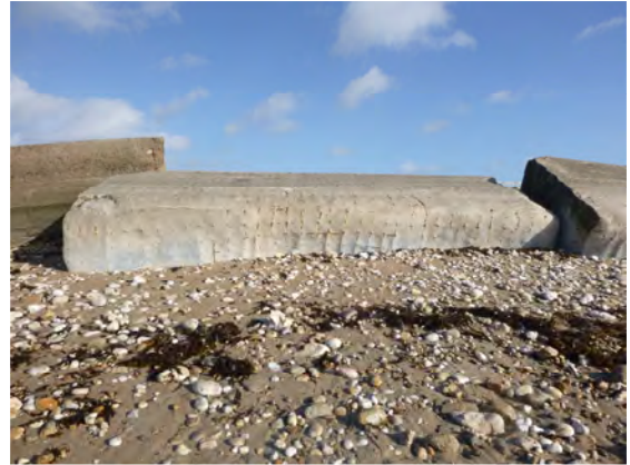
Bloc 2018-M2-B-5-0 affecté par une fissuration subhorizontale traversante correspondant à des reprises de bétonnage et 2 fissures subverticales continues mais peu ouvertes
