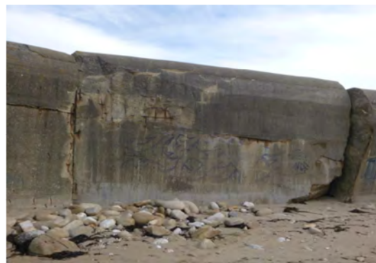
armatures métalliques superficielles au droit du bloc 1 du mur M3
