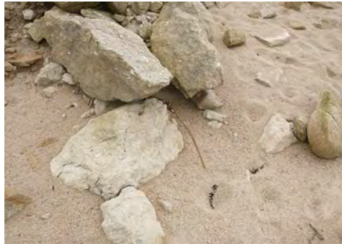
A proximité de la micro-falaise, au droit de la limite des blocs 2018-M2-B-13-0 et 2018-M2-B-14-0, armatures en saillie sur 80cm
