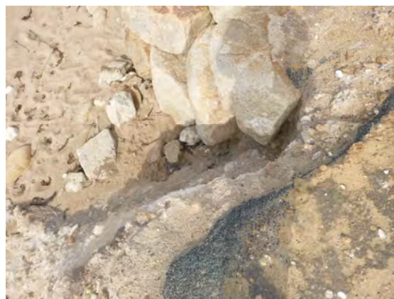
lessivage par la mer des terrains d'assise, en rive du cordon d'enrochements sur une profondeur de 0.2m
