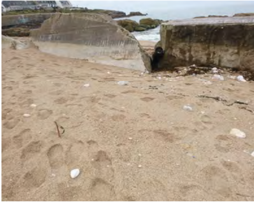
Sur la plage, à ~7m à l'arrière du bloc 2018-M2-B-12-0, armatures ressortant du sable sur 15cm
