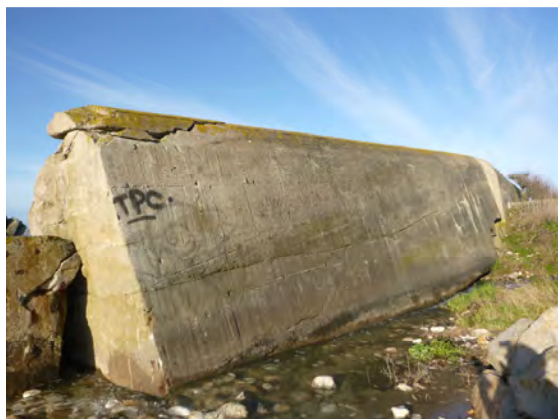
Fracturation en partie haute du bloc 2018-M2-B-2-0 sur ~ 2m de long associée à des épaufrures consécutives au mouvement des blocs 2018-M2-2-0 et 2018-M2-3-0
