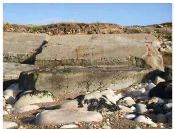
4 ème groupe de blocs résultant d'une fracturation survenue le long d'un joint de bétonnage
