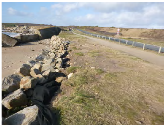
lessivage par la mer en amont du cordon d'enrochements sur une profondeur de 4 à 5m
