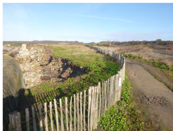
Côté Nord, à ~P170, crête de micro-falaise de 1.8m de haut à ~1.5m du bord du sentier
