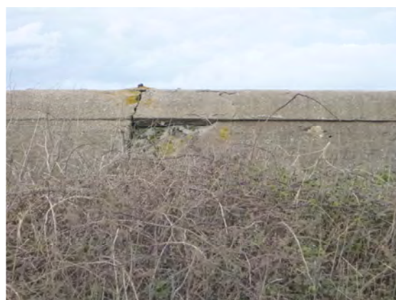
Couronnement du bloc 2018-M4-B-3-0 affecté par de rares épaufrures (0.7m de long)
