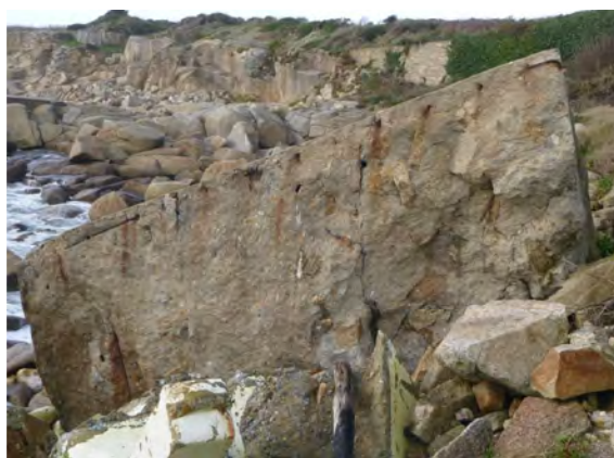
armatures métalliques distantes de 30 cm à 6cm sous le parement du bloc 2 du mur M1
