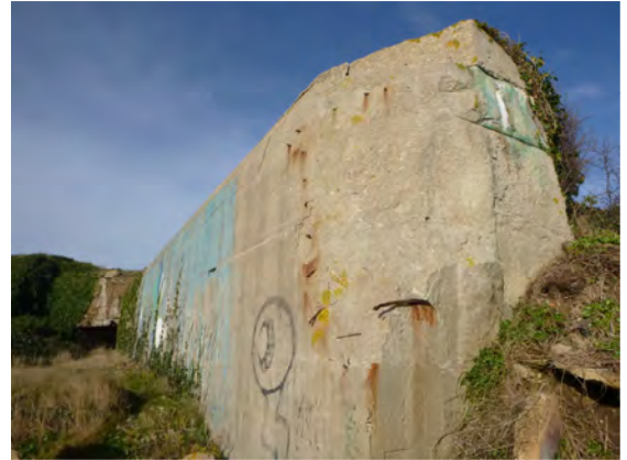
2018-M1-B-1-0 avec parement maritime vertical et affecté en partie supérieure par une épaufrure et présentant des armatures métalliques corrodées en saillie sur 40cm
