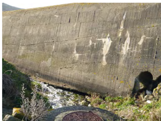
Affouillement du bloc 2018-M2-B-2-0
