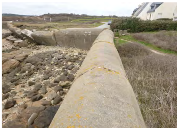
Défaut d'alignement du mur M4 au droit de la partie Nord
