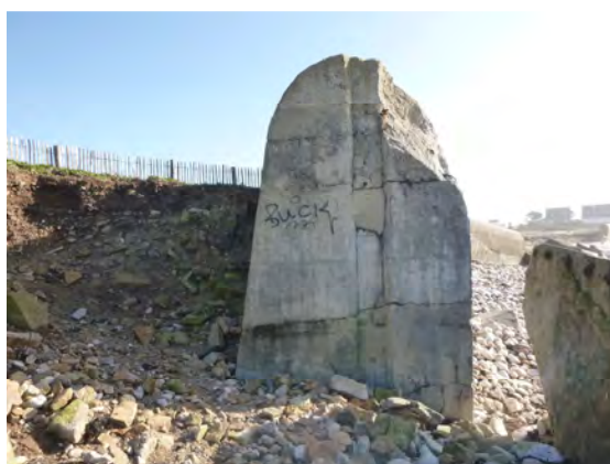
bloc 2018-M1-B-19-0 offrant un parement maritime vertical et affecté par une fissuration subhorizontale traversante correspondant à des reprises de bétonnage
