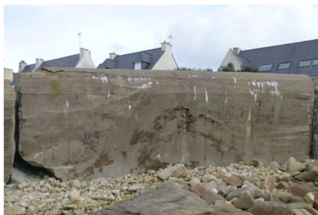
2018-M3-6-0 basculé et affecté par des épaufrures en parement et en couronnement
