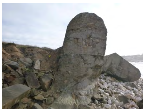
Bloc 2018-M1-B-10-0 montrant une inclinaison anormale vers l'aval du parement maritime de 82° significatif de son basculement
