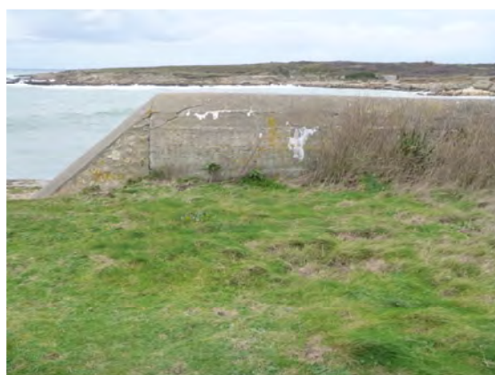
Couronnement du bloc 2018-M4-B-4-0 affecté par une fissuration subhorizontale soulignée par des efflorescences
