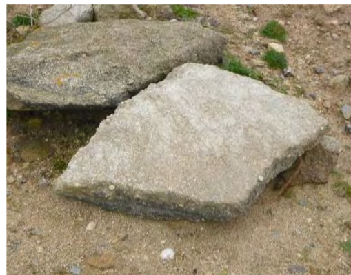
Au droit d'un accès à la plage, à l'arrière du bloc 2018-M2-B-15-0, morceau de semelle avec armatures en saillie sur 20cm
