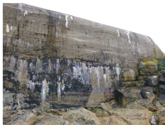
Sud du parement maritime du bloc 2018-M4-B-4-0 affecté par une fissuration subhorizontale soulignée par des efflorescences
