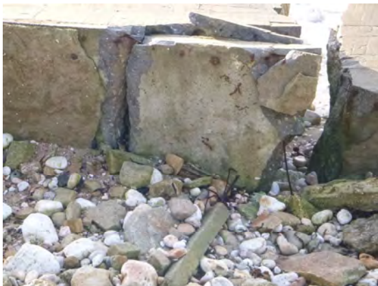
Ferrailage dans les débris à l'arrière du bloc 2018-M1-B-18-0
