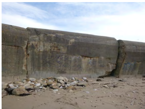
2018-M3-1-0 basculé et affecté par une fissuration traversante liée à des reprises de bétonnage et soulignée par des efflorescences ainsi que des épaufrures peu profondes générées par la corrosion des armatures de peau
