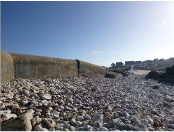
Accumulation de galets en haut d'estran au droit du linéaire allant de ~P140 à ~P 230
