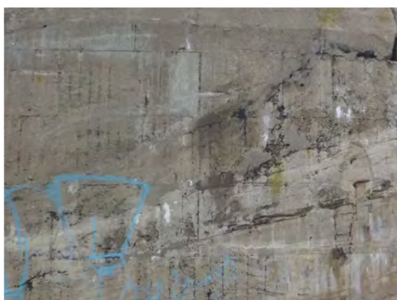
Parement maritime du bloc 2018-M4-B-1-0 affecté par une fissuration subhorizontale soulignée par des efflorescences
