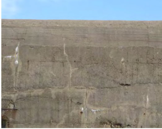
Bloc 2018-M1-B-19-0 affecté par des discontinuités subhorizontales et un réseau de fissure superficiel trahissant le ferrailage de peau
