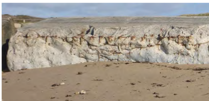
Couronnement du bloc 9 du mur M2 avec treillis d'armatures métalliques avec maillage de 30 cm de côté
