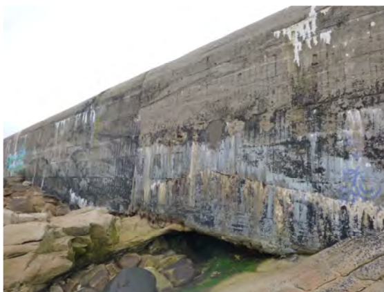
Vers P455, sous-cavage de 1.8m de profondeur avec fortes circulations d'eau au droit du bloc 2018-M4-B-4-0
